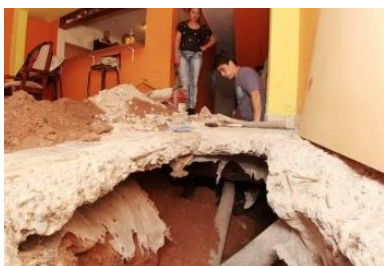
Ilustración 15: Socavones en Alto Hospicio
