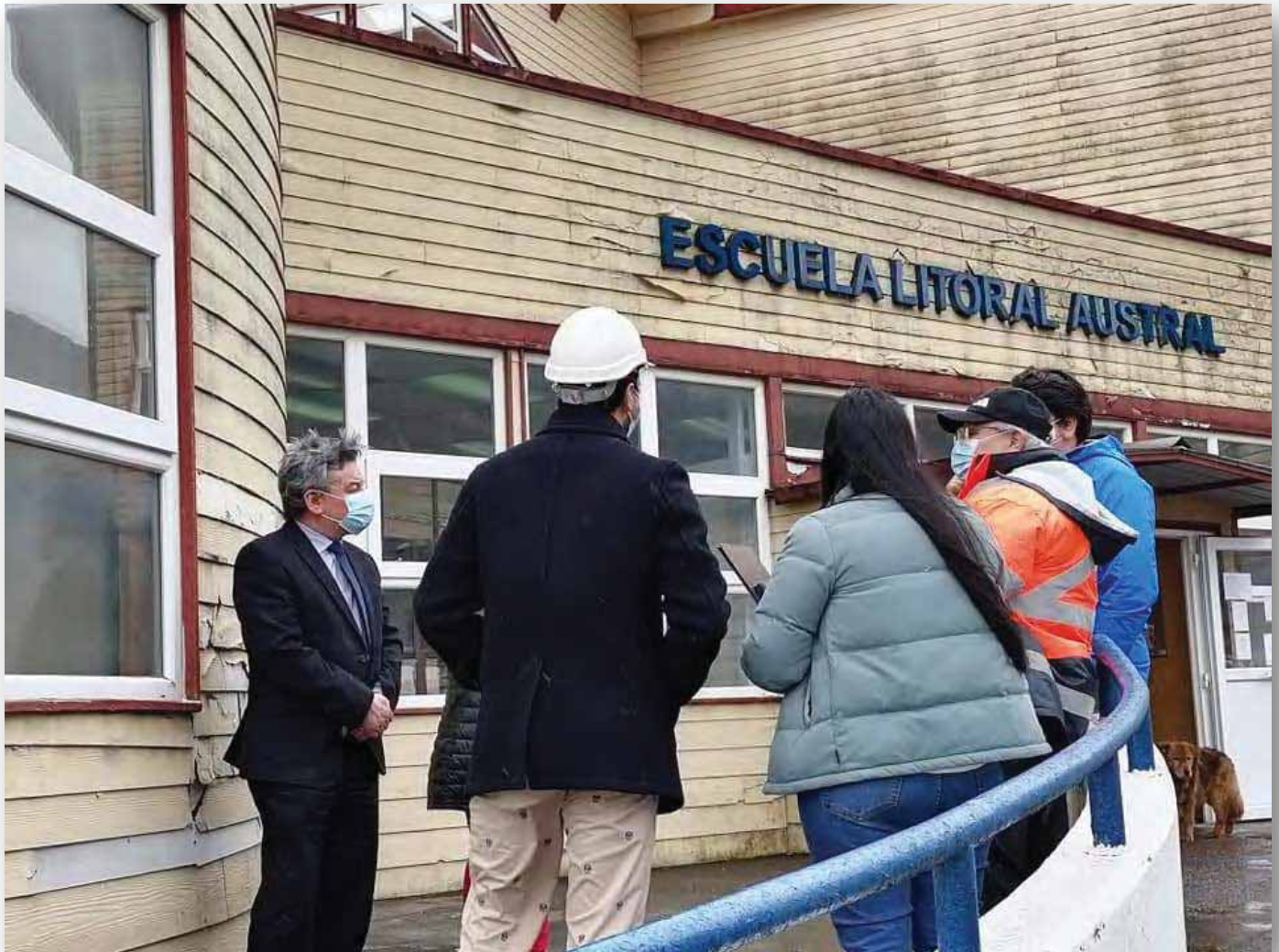
ENTREGA DE TERRENO INICIO OBRAS PROYECTO "MEJORAMIENTO FACHADA ESCUELA LITORAL AUSTRAL" PUERTO AYSÉN
