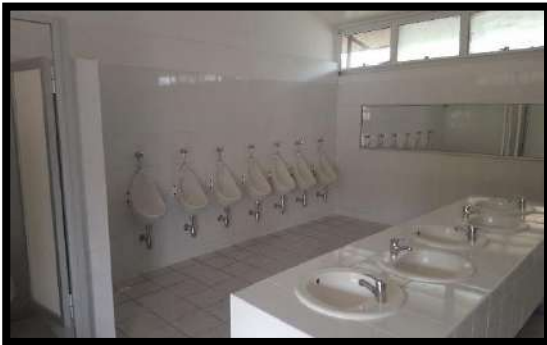
"Mejoramiento de Baños y habilitación de rampas de acceso Escuela Juan Madrid"
