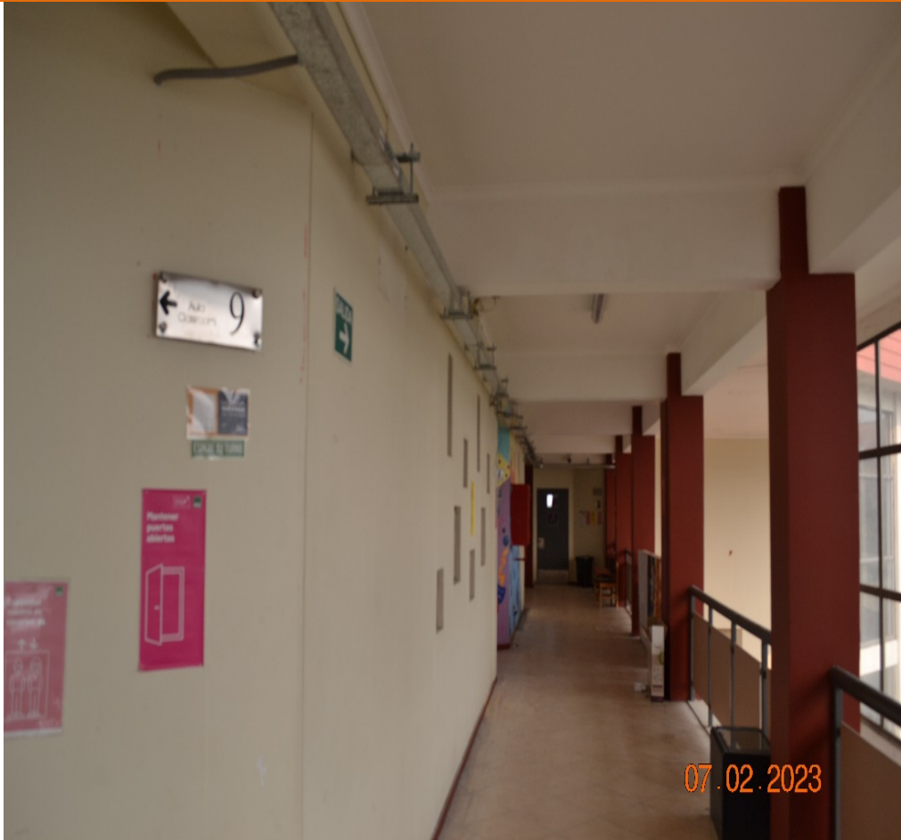
Figura 19. Imagen Canalización Liceo Bicentenario
