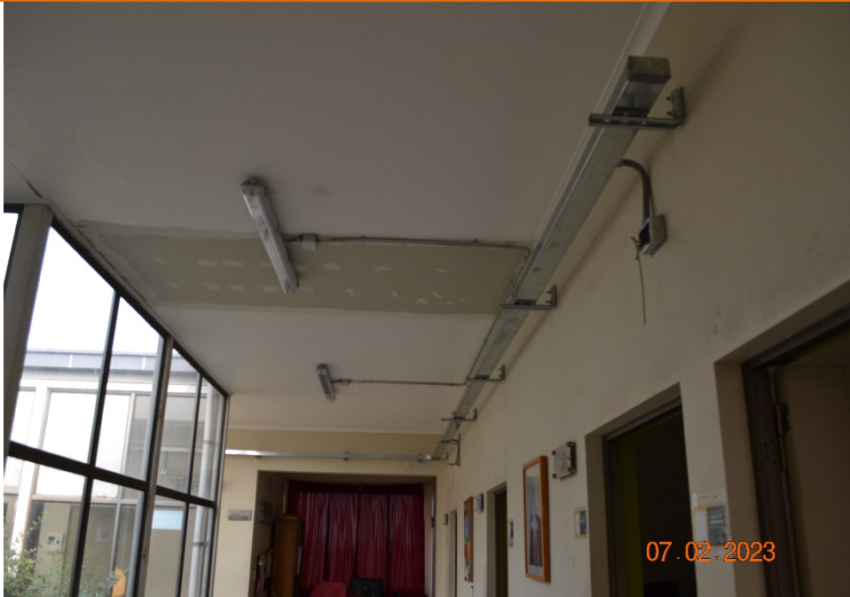
Figura 22. Imagen Canalización E Iluminación Pasillo Liceo Bicentenario.
