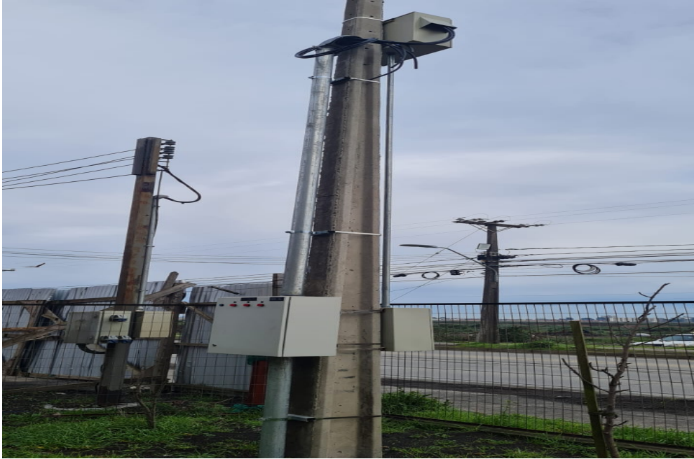
Figura 20. Imagen Caja De Empalme Liceo Bicentenario
