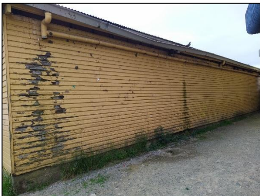
Imagen 05, se realiza desinfección de este sector debido a la presencia de
