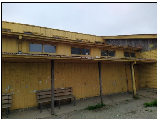
Imagen 09, canaletas SS.HH. en mal estado
