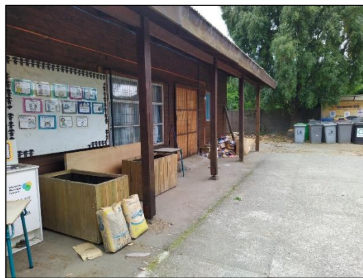
Imagen 08, pabellón nivel especial, no contaba con canaletas de aguas
