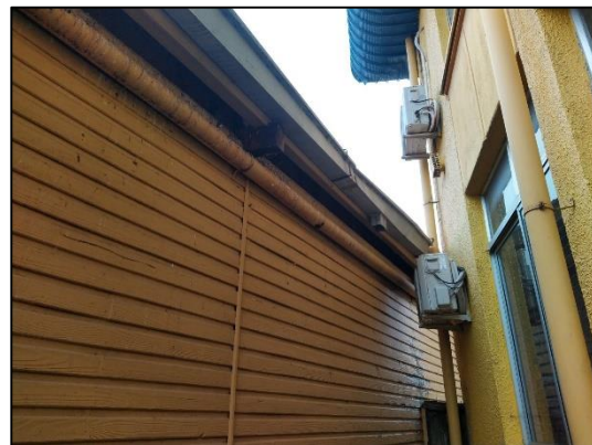
Imagen 06, reparación de aleros en el gimnasio, eliminando anidaciones
