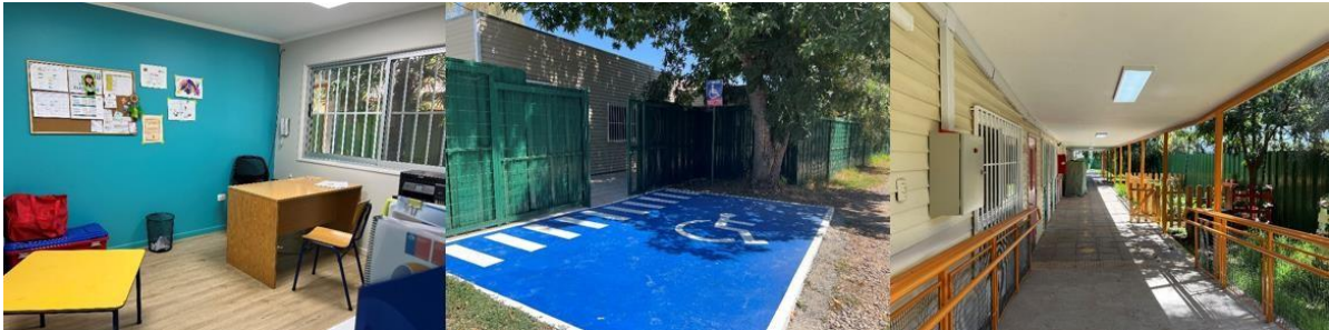
Imágenes de Proyectos en Ejecución: Ampliación y Conservación Sala Cuna y Jardín Infantil Piecitos de Niños y Niñas
