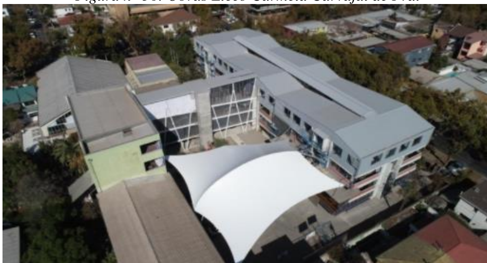
Vista área de reconstrucción 4to piso, tenso estructura y pasarela de conexión
