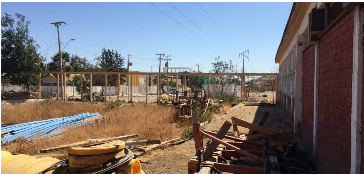
Construcción de nueva pérgola que une salas de clases con el terreno
