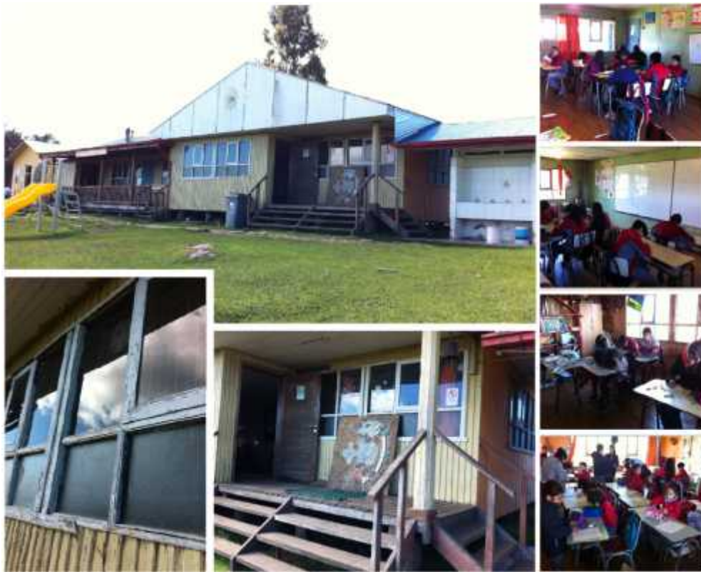
Actual Escuela Punta White. Presenta un alto grado de deterioro.
