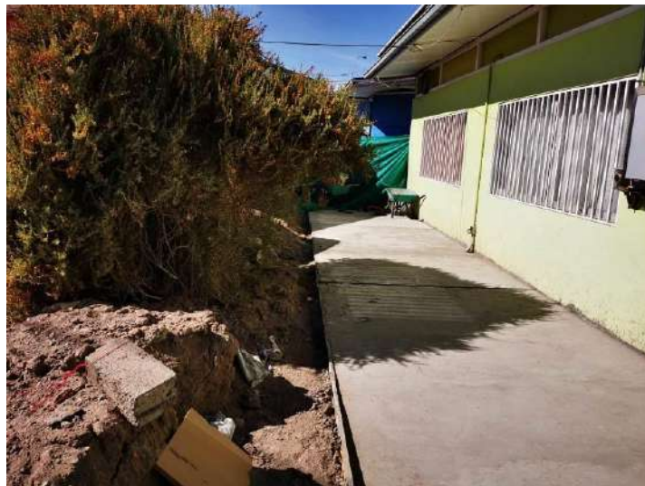
Imagen N°4 Vista radier actualmente realizado, obra paralizada.
