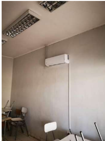
Imagen N° 2 Aire acondicionado instalado en comedor Escuela G-101, Localidad de Sierra Gorda.
