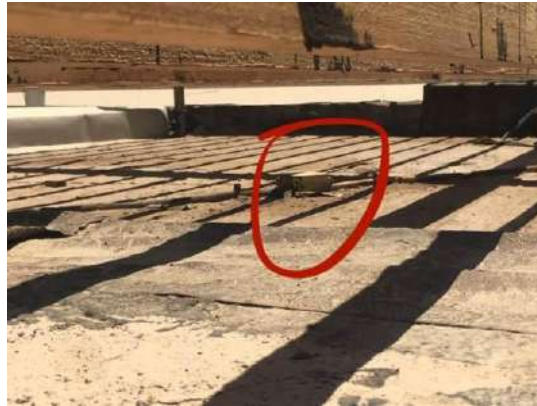
Imagen N°1 Vista general losa actual en recinto, que se encuentra filtrando.
