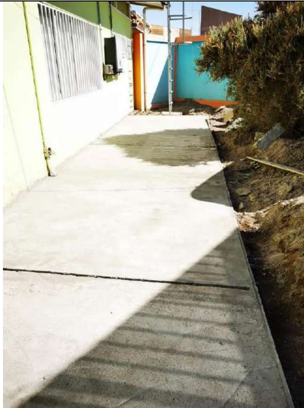
Imagen N°3 Vista general patio bicicletero actual, obra paralizada.
