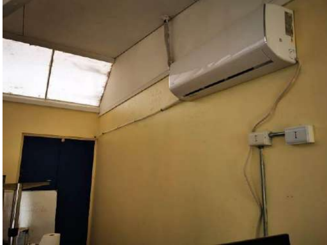
Imagen N°1 Aire acondicionado instalado en Sala Escuela G-130, Localidad de Baquedano.
