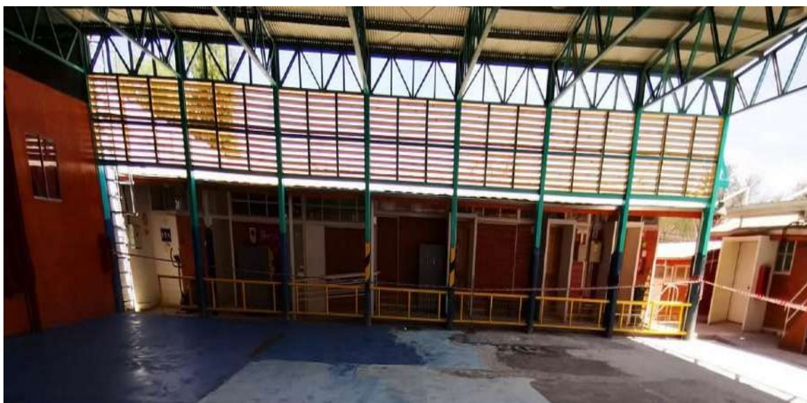
Imagen N°3 Vista general sombrero instalado.
