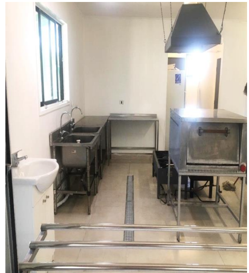
Imagen N°4: Cocina Escuela Aurelio Duran
